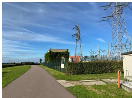
Figuur 3: Voorbeeld 150/25kV station Geervliet-Noorddijk bij Spijkenisse
