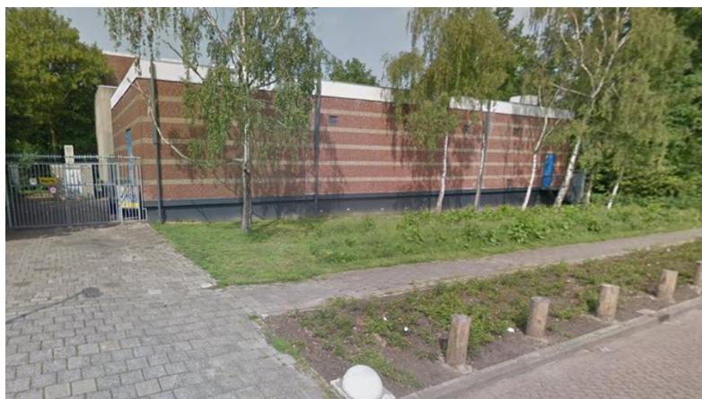
Figuur 2: 25/10kV station van Stedin aan de Van Enckevoirtlaan in Schiebroek
