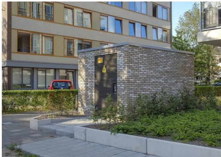
Figuur 1: Voorbeeld elektriciteitshuisje van website Stedin
