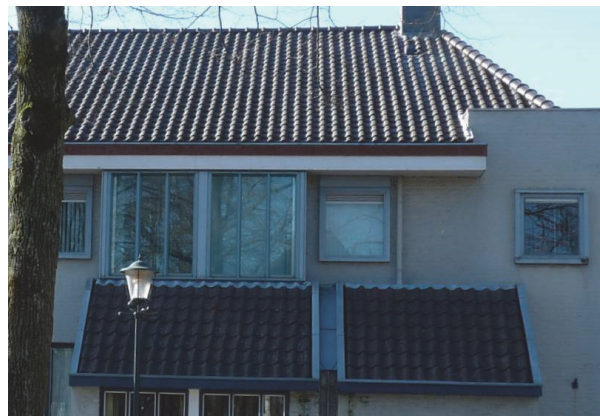
Fig. 4. Detail van het dak, wat geen losliggende dakpannen heeft, en geen sporen van nestvorming in de goot.
