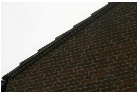
Figuur 4.2.3. Doordat de gevelpannen in de specie liggen kunnen hier geen dieren naar binnen.
