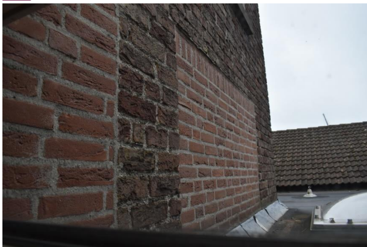
Dichtgemetselde vensters in rechterzijgevel.
