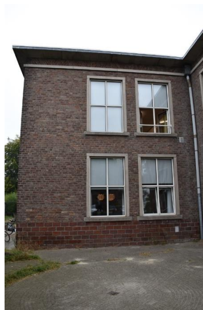
Terugliggend geveldeel linkerzijgevel.
