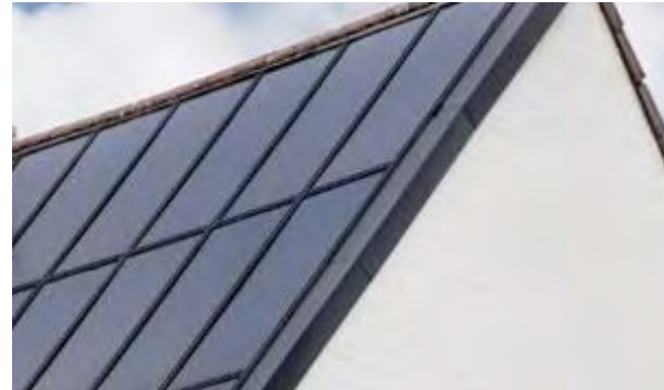
PV geïntegreerd in het dak
