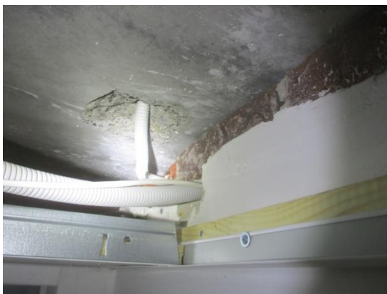
Figuur 22: Punt 12: kabeldoorvoeren in brandscheiding zijn niet afgewerkt
