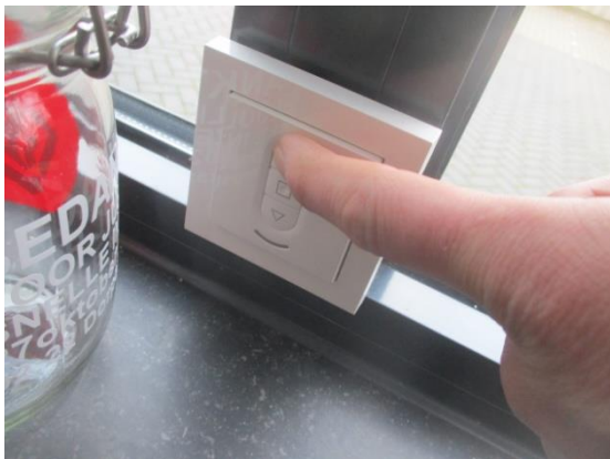
Figuur 11: Punt 3: batterij leeg van draad-loze bediening van screens t.p.v. achtergevel
