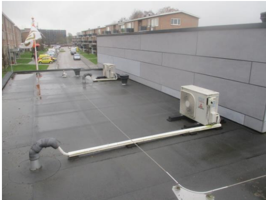
Figuur 1: impressie dakbeveiliging en airco installatie op het dak
