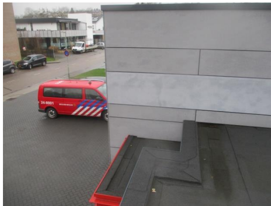
Figuur 4: Punt 2: lichtere gevelbeplating is vernieuwd onder garantie
