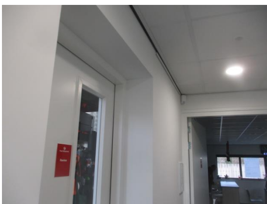
Figuur 16: Punt 6: oppervlakte scheur in dagkant in hal bij deur richting remise
