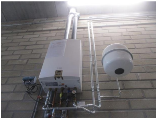
Figuur 8: cv-installatie in remise op hoogte
