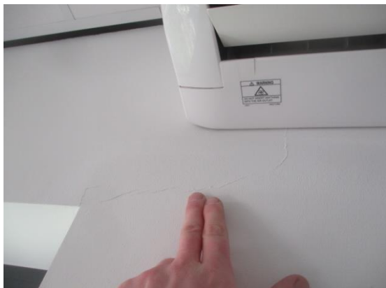
Figuur 13: Punt 5: oppervlakte scheur bij raamopening onder airco binnenunit
