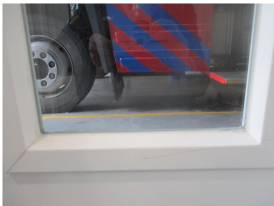
Figuur 21: Punt 11: geen brandwerend logo In beglazing van deuren richting remise
