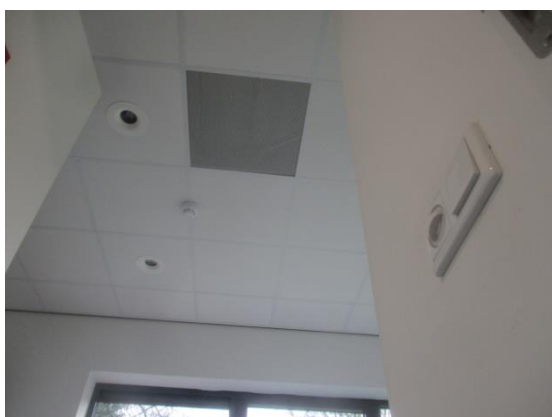
Figuur 15: 3-standenschakelaar en ventilatie voorzieningen functioneren naar behoren
