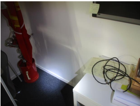
Figuur 12: Punt 4: oppervlakte scheur in wand tussen leslokaal en kantoor
