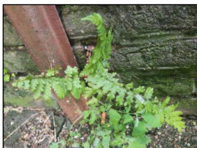
Figuur 5.1. Blaasvaren onder brandtrap op noordelijke luchtplaats.
