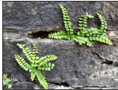
Figuur 10. Steenbreekvaren op één van de buitenmuren.
