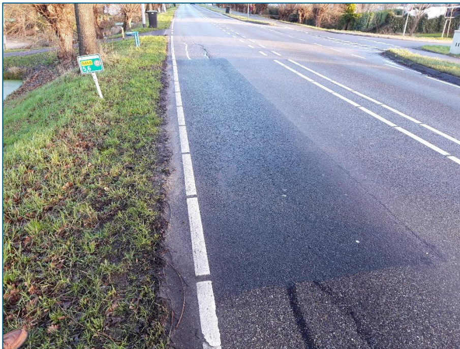
Foto 3. Reparatievak en langsscheur Oostkanaalweg
