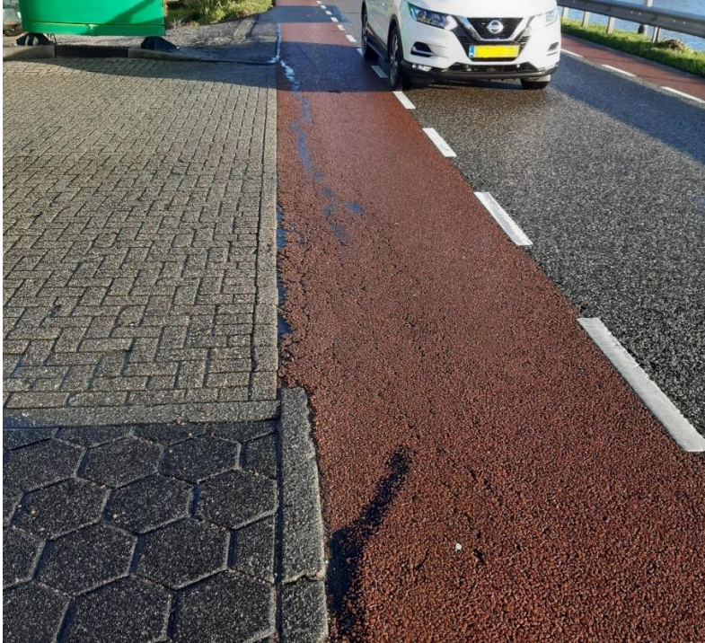
Foto 6. Scheurvorming/craquele Westkanaalweg nabij ca. km 6.050
