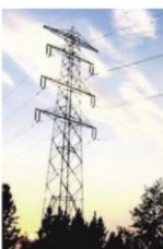
▲ Een 150-kV-hoogspanningsmast bij Zetten.
