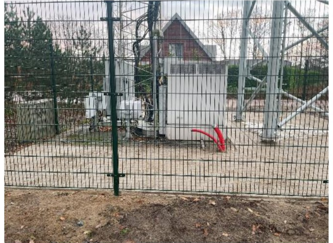
Oude zendmast past naast de nieuwe (inclusief apparatuur)
