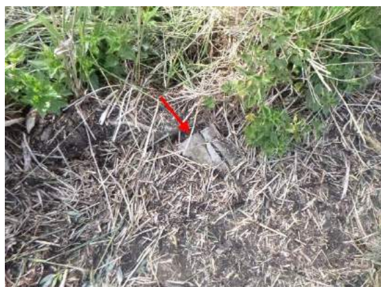
Foto 9 | Foto voor bron Restanten golfplaat
