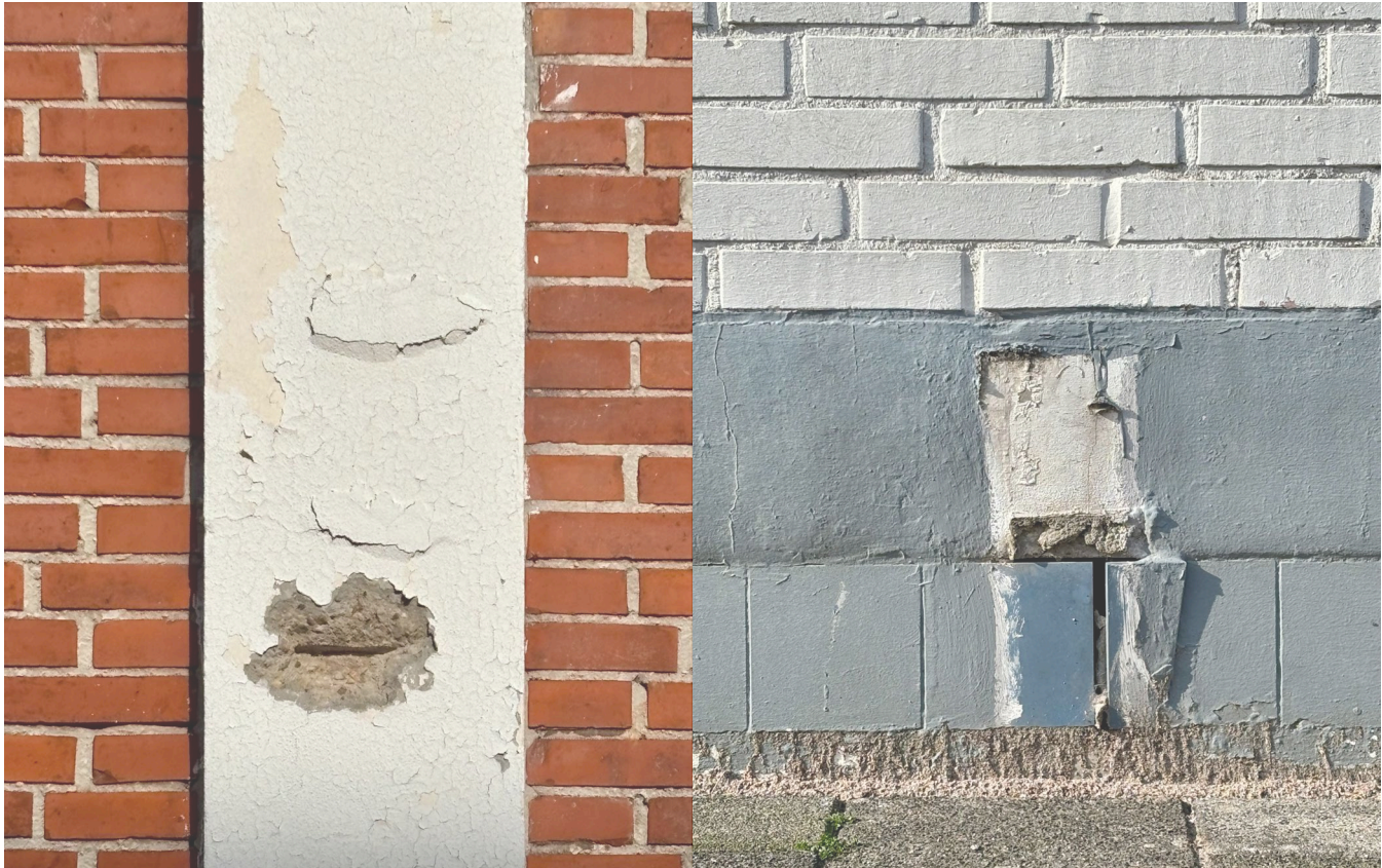
Beschadiging in de betonnen kolom en aangetast voegwerk
