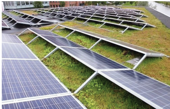
Zonnepanelen in combinatie met groene daken
