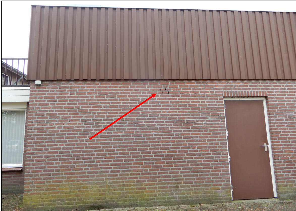
Figuur 5: open stootvoegen in het bedrijfspand Sint Josephplein 15a (rode pijl)
