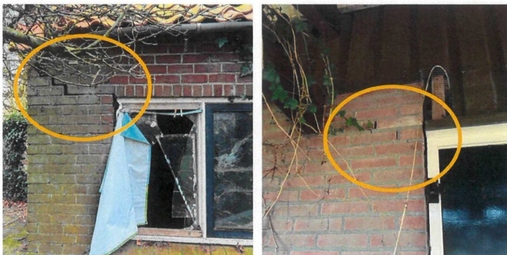
Figuur 4: Visuele bouwschade bij woning en schuurtje in het gebied waargenomen tijdens het veldbezoek
