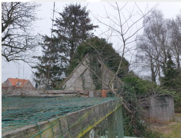
Klimop en takken rondom de gebouwen belemmeren sterk de toegang voor uilen en vleermuizen.
