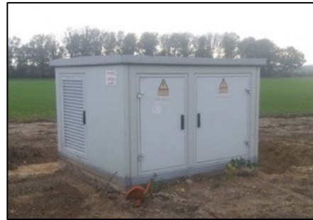
Figuur 29: voorbeeld trafo-station
