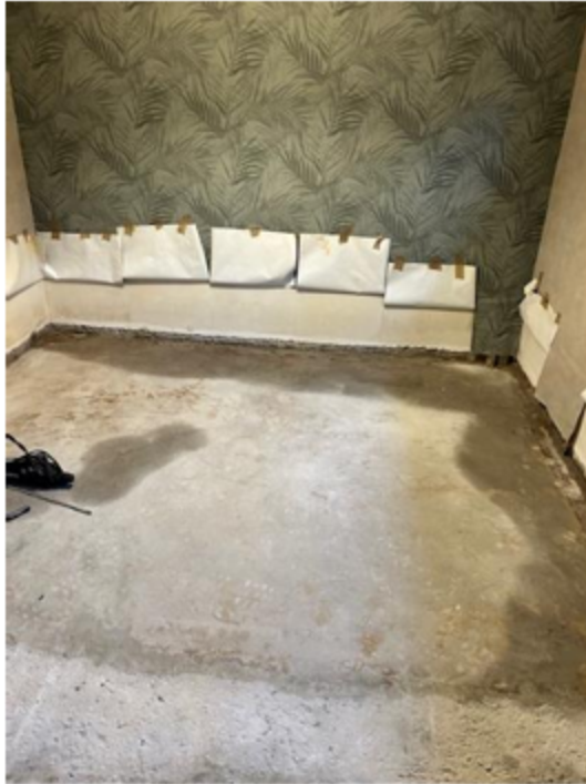
Afbeelding 6: Opgetrokken bodemwater in vloeren en muren van de slaapkamers.
