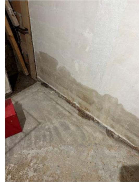
Afbeelding 8: Opgetrokken bodemwater in vloeren en muren van de slaapkamers. Een droger is wederom geplaatst.
