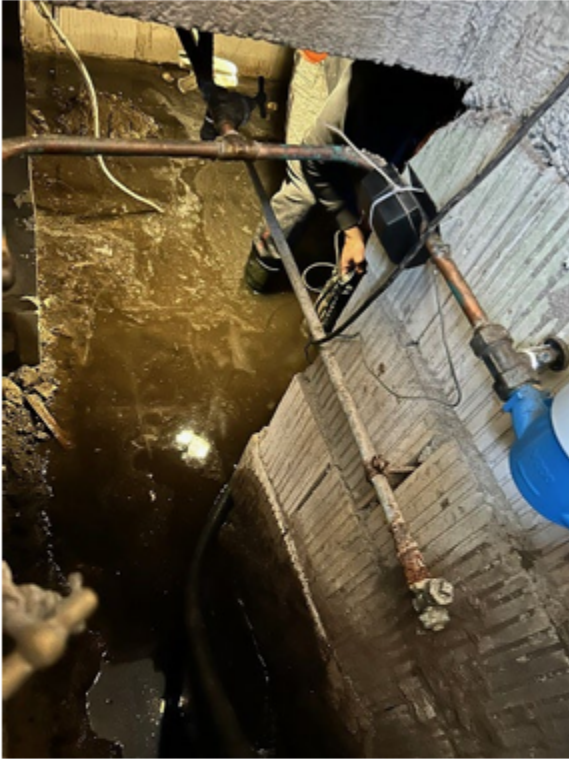
Afbeelding 1: 30cm hoog water. Kruipruimte voorste gedeelte (ingang luik bij de voordeur).
