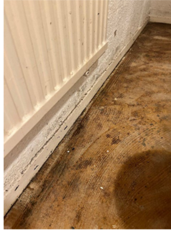
Afbeelding 3: Schimmelvorming 'overloop' naar slaapkamers in souterrain. De vloerbedekking is hier verwijderd.
