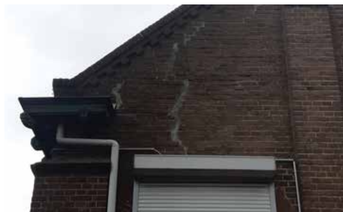
Scheur in muur
