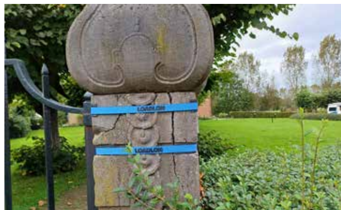
Gebroken hardstenen hekpijler
