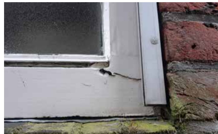
Houtrot in kozijn
