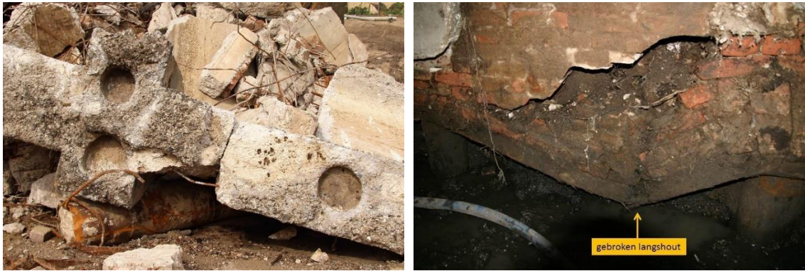
Figuur 10 Links Voorbeeld van een voormalige betonnen funderingsbalk. Duidelijk zijn de gaten te zien waar de palen hebben gezeten. Rechts: een voorbeeld van een gebroken houten funderingsbalk (langshout).
