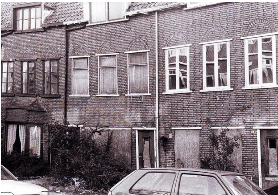
Figuur 20 Boven: En blokje geharnaste woningen in de Lisbloemstraat. Onder: woningen in de Duizendschoonstraat. Beide blokken waren zover gedeformeerd dat ze moesten worden afgebroken.
