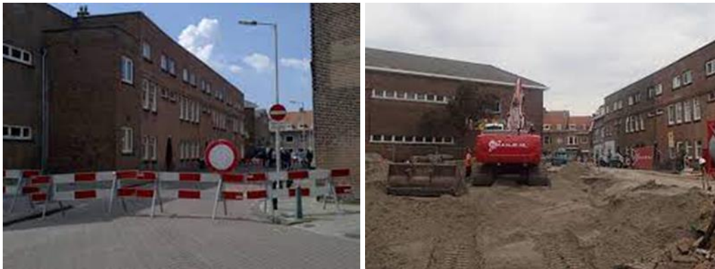
Figuur 31 Woningen in de Margrietstraat zijn van de fundering geschoven, verzakt en uiteindelijk afgebroken.
