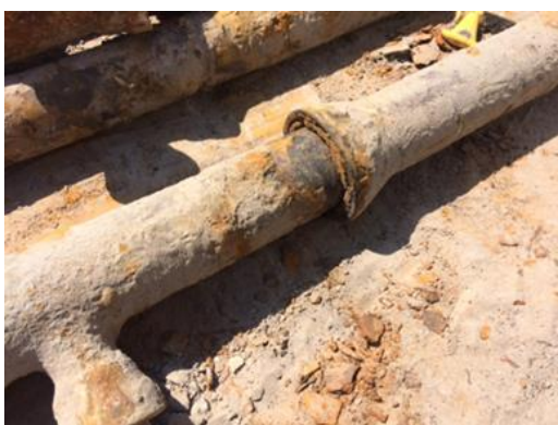
Figuur 55 In de Baroniestraat wordt bij graafwerkzaamheden ook gasbuizen blootgelegd. Ze blijken in zeer slechte staat te verkeren. De werkzame mensen noemen de situatie erg gevaarlijk. Bewoners 'zouden op en bom wonen'. Een vergelijking met de eerste calamiteit in de Bloemenbuurt van 1925 doemt op.
