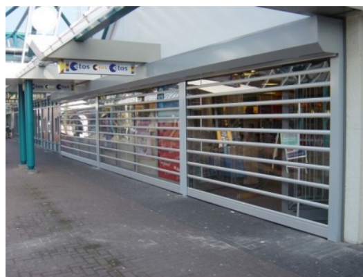
Afbeelding 48 rolluik voldoet / bak en geleiders voldoen niet
