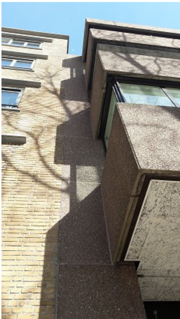
Gesloten voegwerk zonder geschikte invliegopeningen voor vleermuizen.
