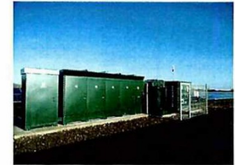
Referentiebeeld - v.l.n.r. Omvormer, Transformator en Switchgear
