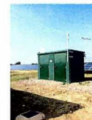
Referentiebeeld - Monitoring station
