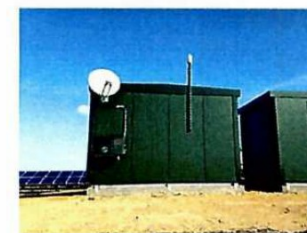
Referentiebeeld - Monitoring station
