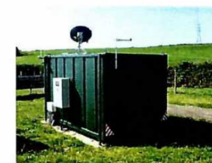
Referentiebeeld - Monitoring station
