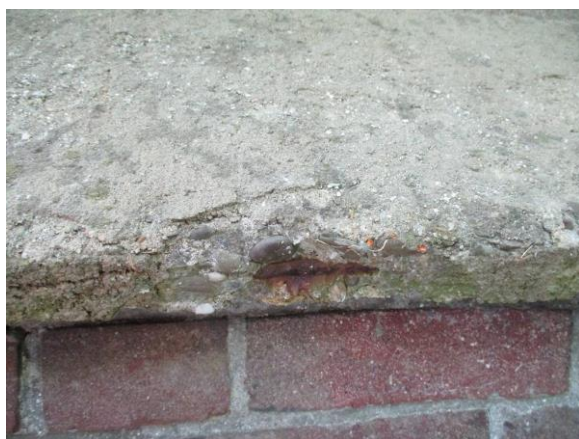
Foto 33 Betonschade borstwering / frontwand oost
