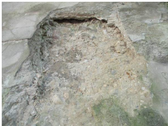
Foto 19. Loszittende reparatielaag landhoofd zuid
