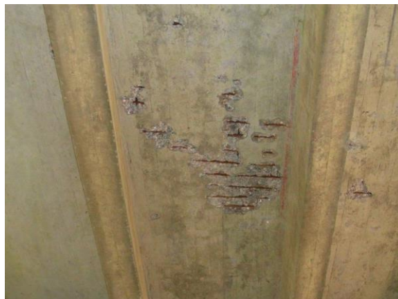
Foto 8 Schadeplekken onderzijde dek
