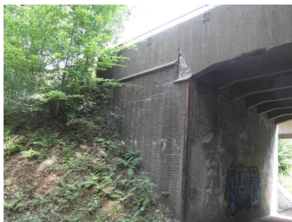
Foto 28 Betonschade frontwand west
