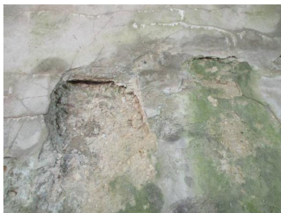
Foto 18. Loszittende reparatielaag landhoofd zuid
