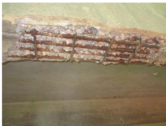
Foto 6 Roestende wapening onderzijde balk
