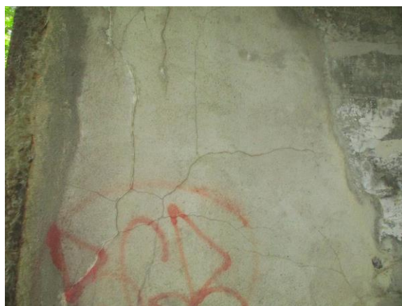
Foto 22. Scheurvorming landhoofd noord
