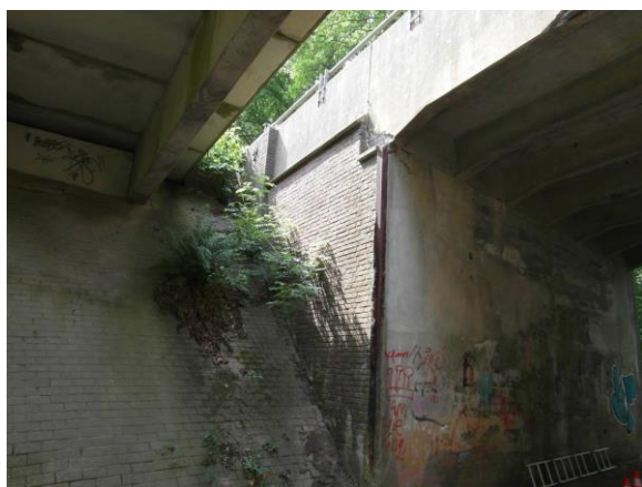
Foto 27 Betonschade frontwand oost
