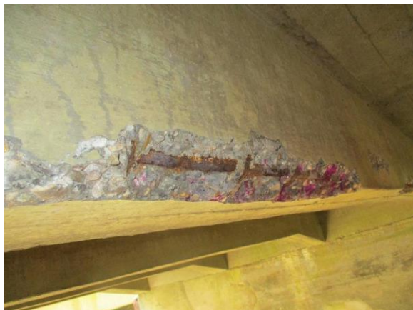
Foto 7 Carbonatatiemeting t.p.v. schadeplek balk
