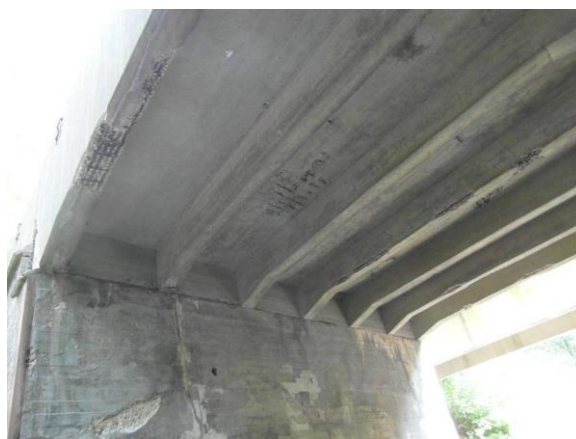
Foto 16. Aanzicht schade onderzijde dek
