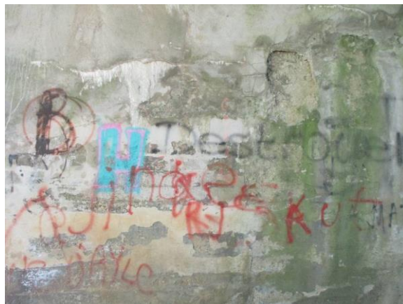
Foto 20. Schadeplekken landhoofd zuid
