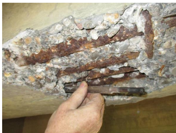
Foto 12 Holle ruimte achter oppervlak balk
