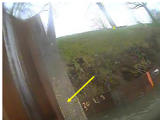
Foto 4 – Houtwerk verspreid over de bodem. vermoedelijk van een oude grondkering of beschoeiing
