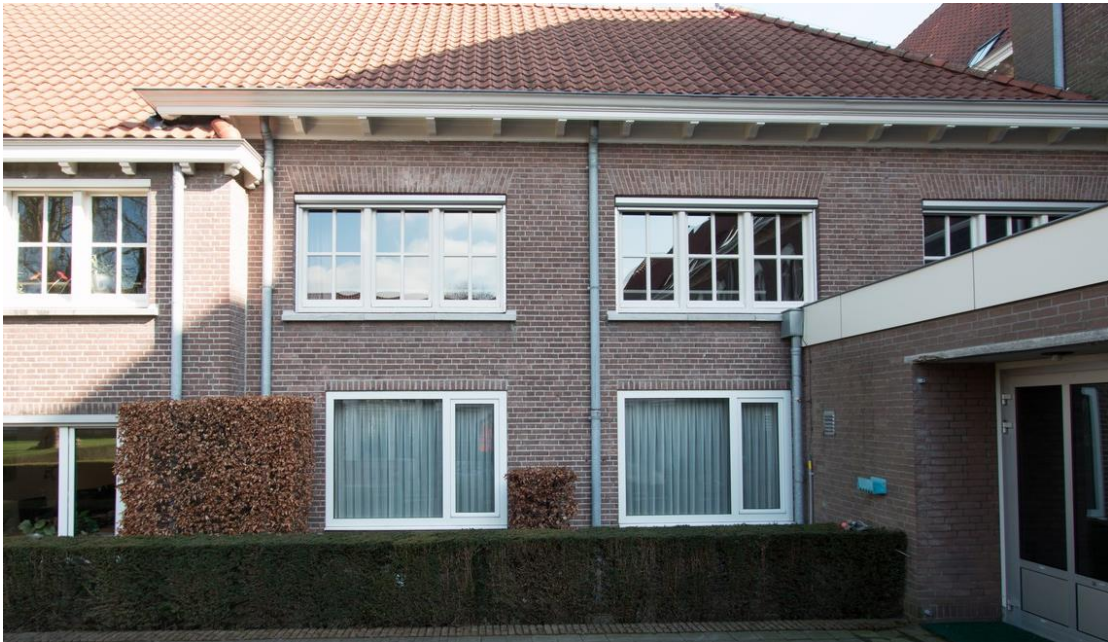
In detail twee van de toegevoegde vensters. In de ramen bovenin de gevel valt vooral de nieuwe beglazing in negatief opzicht op.
