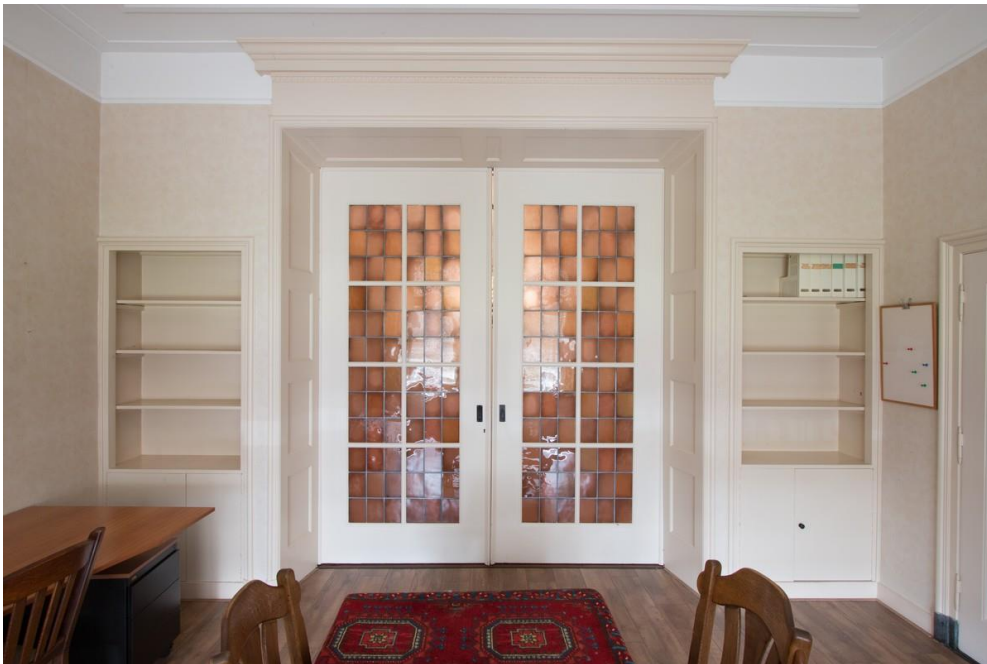
De suitewand waarvan kastdeuren zijn verwijderd en de schuifdeuren niet oorspronkelijk glas-in-lood hebben.
