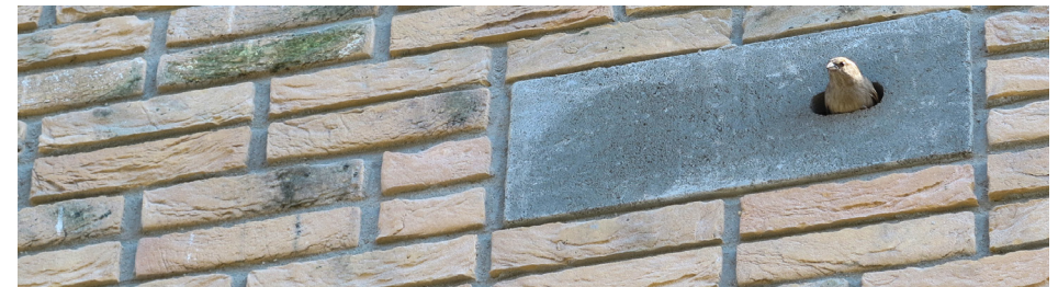
Huismuskasten in gevels
