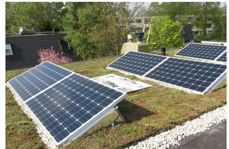
Zonnepanelen op plat groendak
