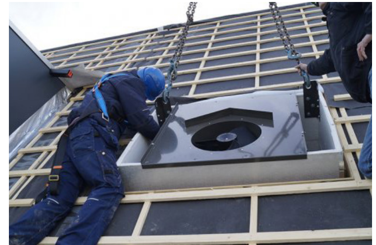
Luchtwarmtepomp geïntegreerd in dakvlak
