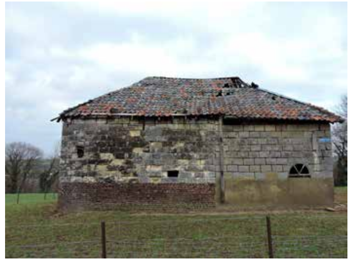
2. De gevel aan de straatzijde: links is het oudste en dus meest verweerde deel. De verticale balk tegen de muur stabiliseert een ondermaats spant aan de binnenzijde. Voor alle mergel geldt dat die door niet-deskundigen is verwerkt, immers, een mergelwerker zorgt voor minimale voegen om verweer tegen te gaan. Bij het hergebruik dat hier heeft plaatsgevonden, en waarbij blokken van ongelijk formaat zijn gebruikt, was daar geen aandacht voor. Vandaar de dikke voegen met een grove specie. Het schilddak is gedekt met Vlaamse pannen in verschillende kleurschakeringen. Links is de oplopende dakaansluiting afgedekt met nokpannen van het type mulden, rechts deels met een strook zink
