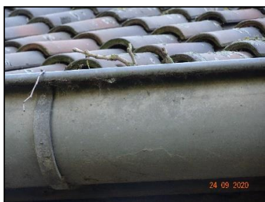
Figuur 15. Detailfoto van de dakgoot van het woonhuis. Zichtbaar zijn takjes die boven de dakgoot uitsteken.
