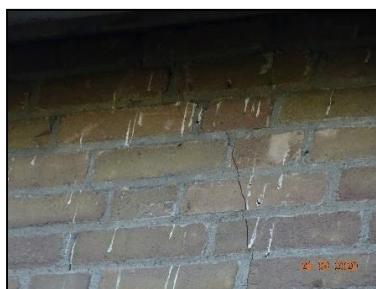
Figuur 16. Poepspoor op de buitenmuur onder de dakgoot van het woonhuis.
