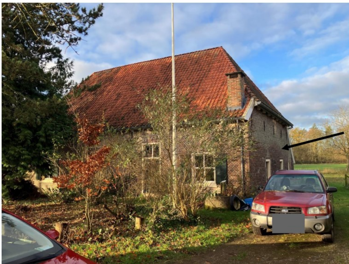
Advies: gevel opnieuw voegen 1
