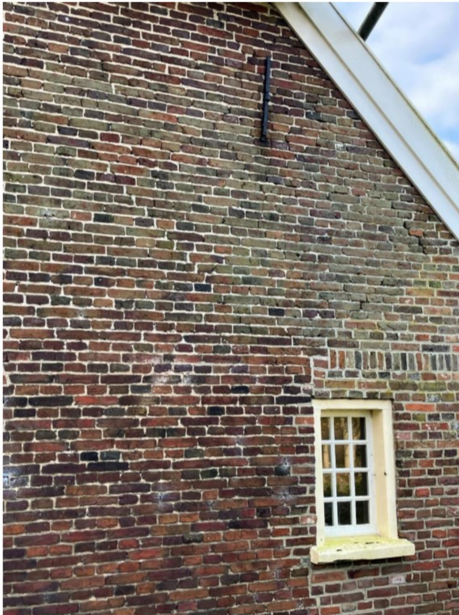
Advies: gevel opnieuw voegen
