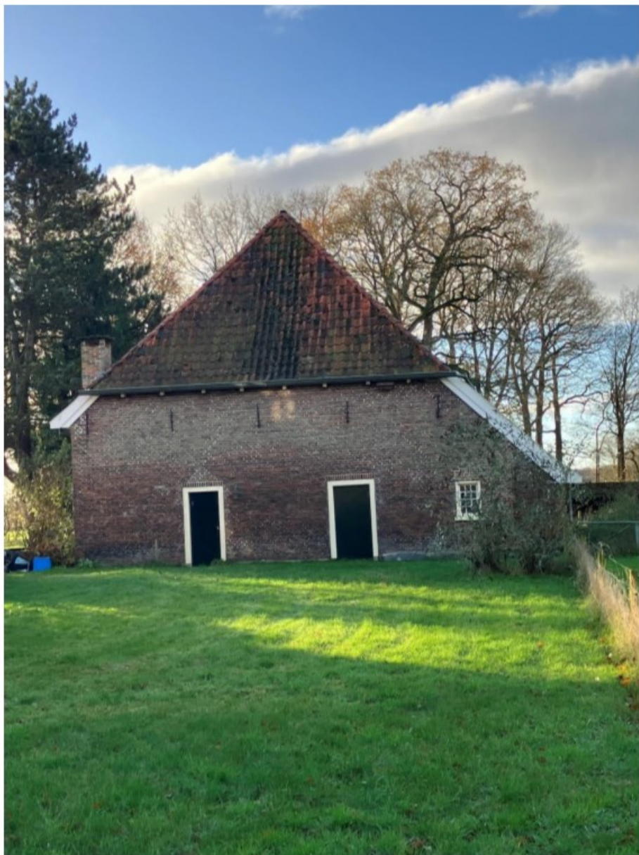
1 Advies: gevel opnieuw voegen
