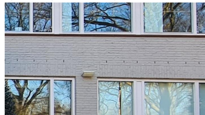
Figuur 3: Open stootvoegen in de westgevel van het kantoorpand
