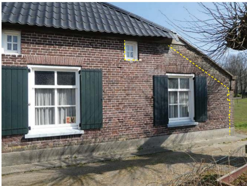
Detail van voor- of zuidwestgevel, in geel 'braaksporen'.
