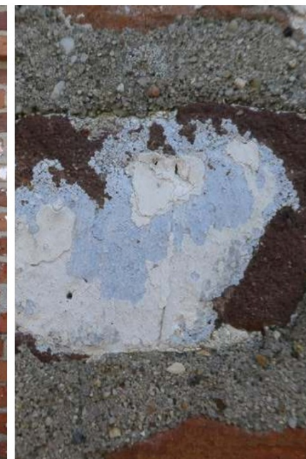
Detail van gekalkt afweerkruis boven kelderlicht.
