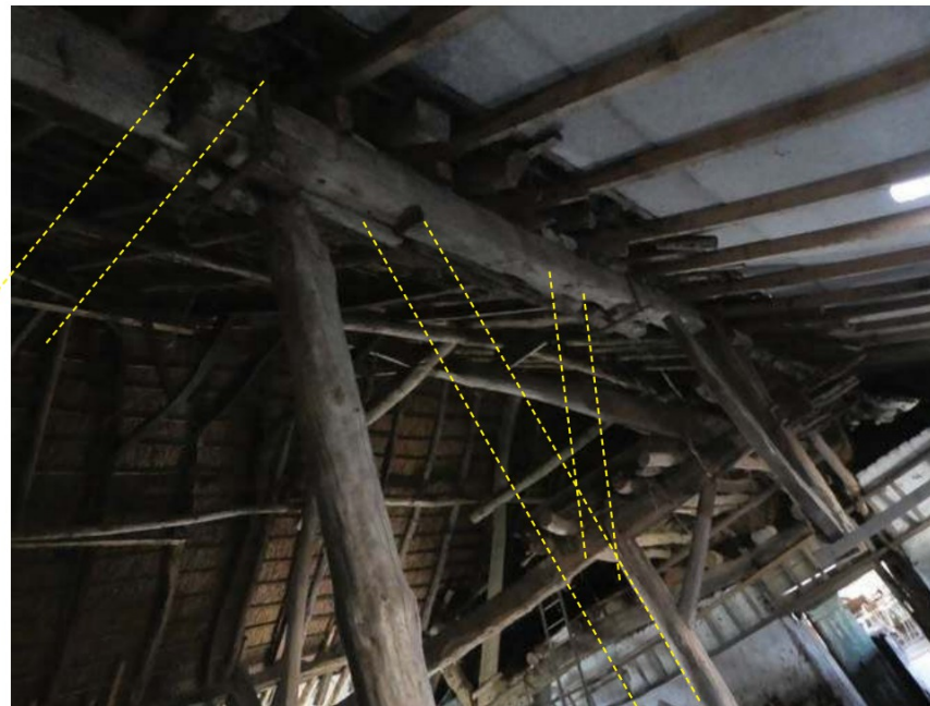
Cebintplaat en stijl op B8. In geel de oude locaties van stijl, schoor en eindplaat.
