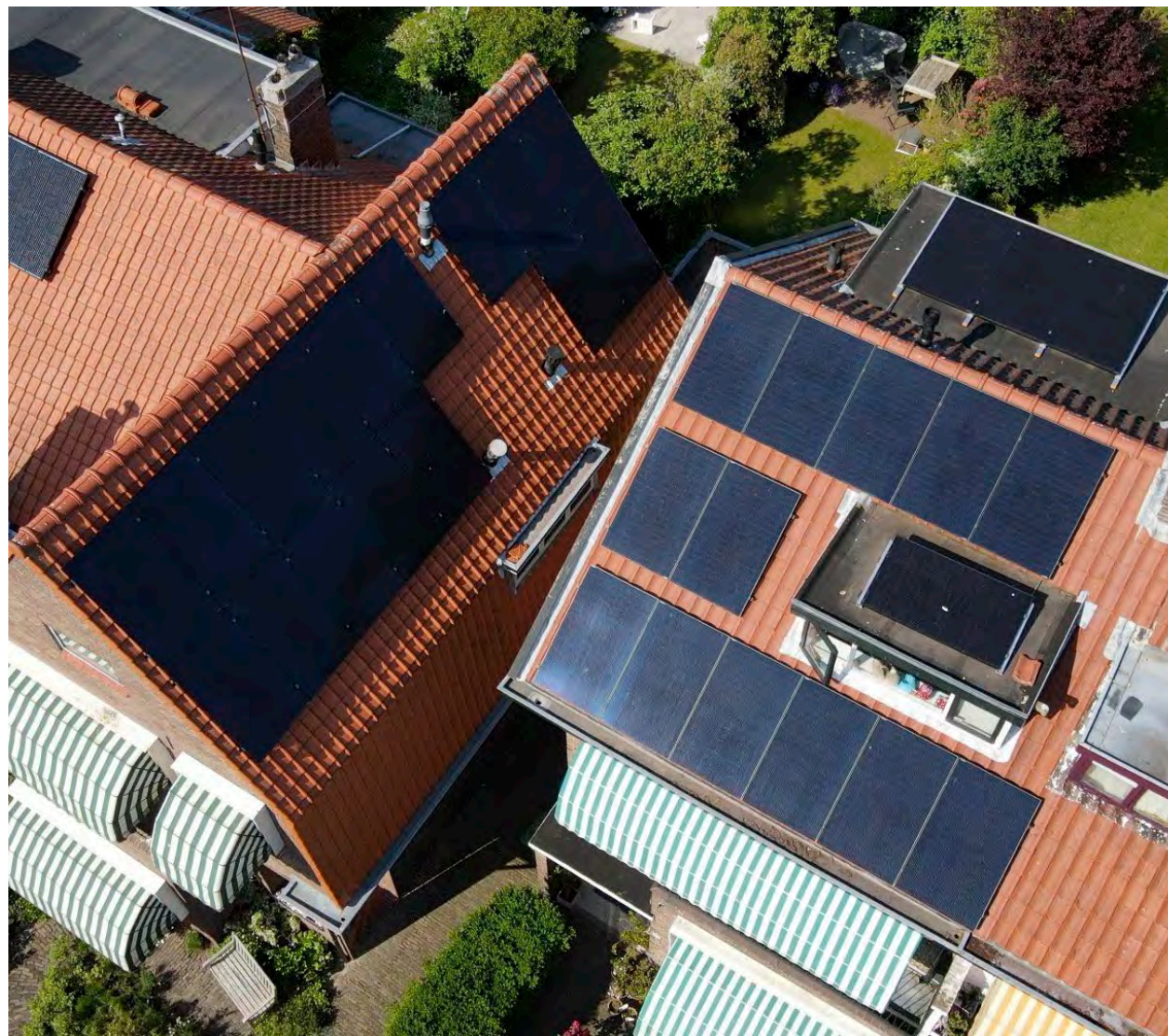
PV-panelen (bron: gemeente Leidschendam-Voorburg)
