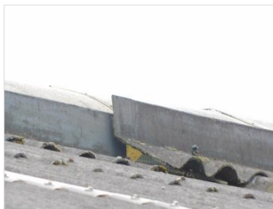
Figuur 5.13 Openingen in het dak van de schuur (gebouw 4).
