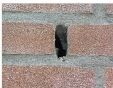
Figuur 5.24 Detailfoto van de open stootvoeg bij het clubhuis van Sportclub Westervoort (gebouw 3).
