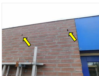
Figuur 5.23 Open stootvoegen in het clubhuis van Sportclub Westervoort (gebouw 3).
