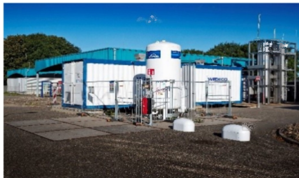
Met het project S.C.H.O.O.N. onderzoekt het hoogheemraadschap hoe het gezuiverde water extra kan worden gezuiverd om het vervolgens in het gebied te kunnen terugbrengen, in plaats van het te lozen in zee of in de Nieuwe Waterweg. Met de proefinstallatie "de zoetwaterfabriek" op De Groote Lucht in Vlaardingen zijn de extra zuiveringsstappen onderzocht. 25
