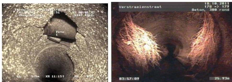
Figuur: schade aan riolering, breuken en wortelgroei
