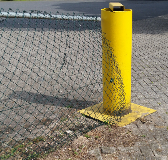
Staat van onderhoud hekwerk laat te wensen over Ovenberg
