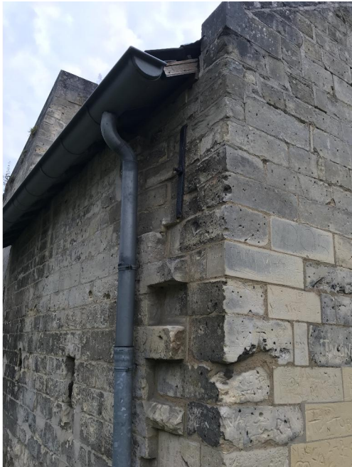
Foto 4: Duidelijk zichtbaar dat de voorgevel in het verleden los is gekomen van de zijgevel.
