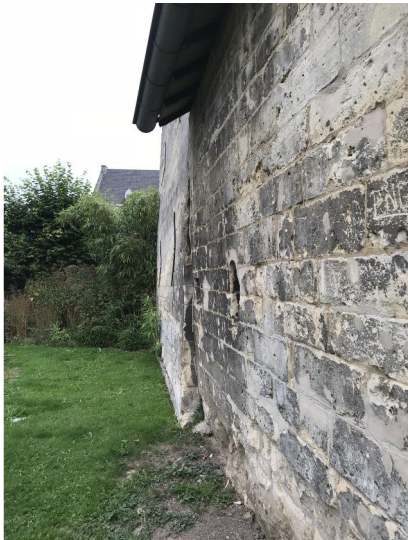
Foto 1: aansluiting gevel kruithuisje aan vierkante toren. Duidelijk zichtbaar dat gevel uit het lood staat.
