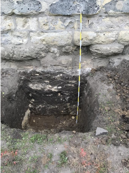
Foto 11: Onderzijde fundering gevel met scheefstand op ca. 0,9m-maaiveld
