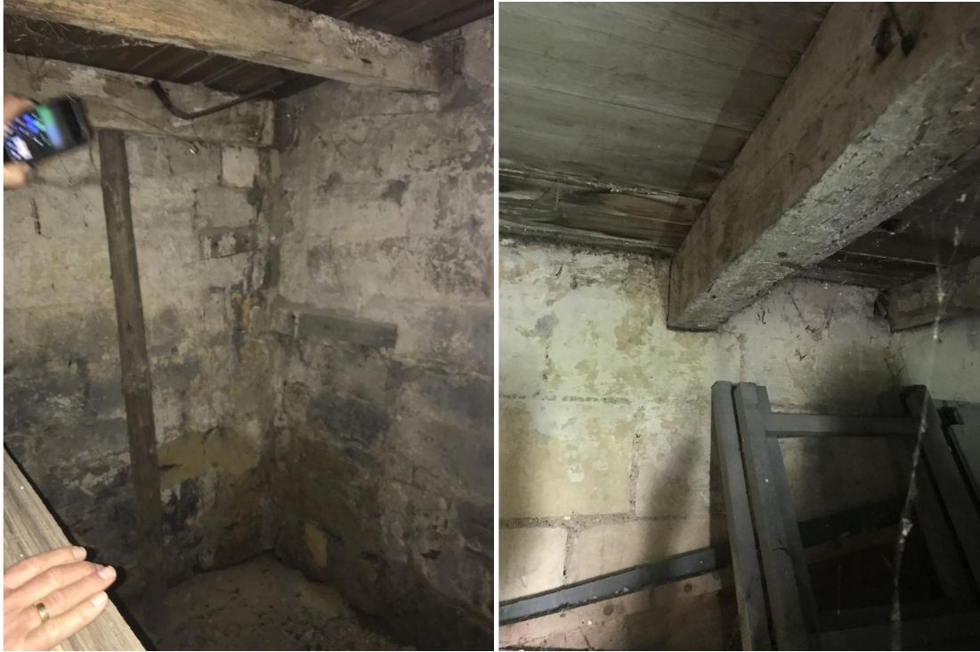
Foto 9 en 10: Oplegging in wand met scheefstand en de oplegging in de stadswal, balk ligt nog maar net op in mergelwand.
