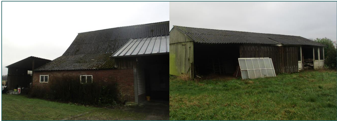
Figuur 1.3 Fotografische indruk van de omgeving van de planlocatie. Links de grote schuur (2) en rechts de halfopen schuur (4).
