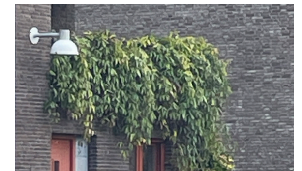
voorbeeld verlichting aan de gevel
