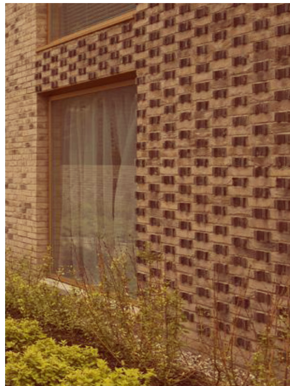
vlakken en kleurverschil door sobere rijk metselwerk
