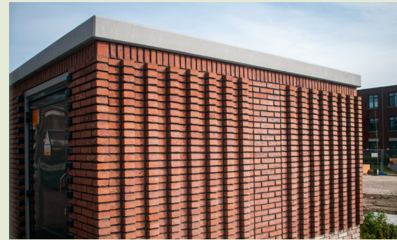
trafo in stijl aangrenzende architectuur
