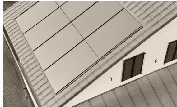
PV-panelen in kleur
