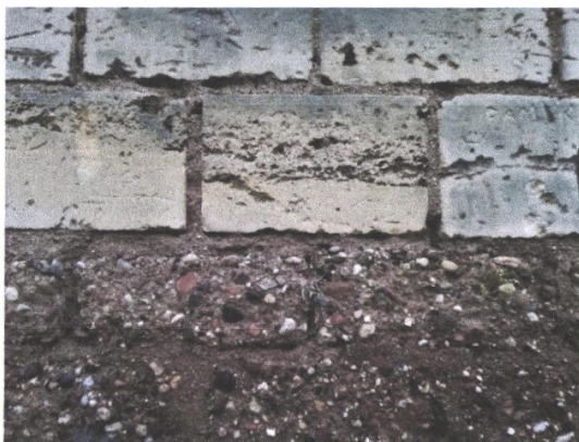
Zwaar beschadigde muur voorgevel
