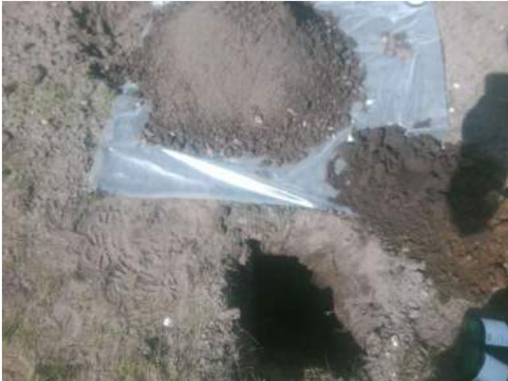
Foto 3. Asbest gat B03
