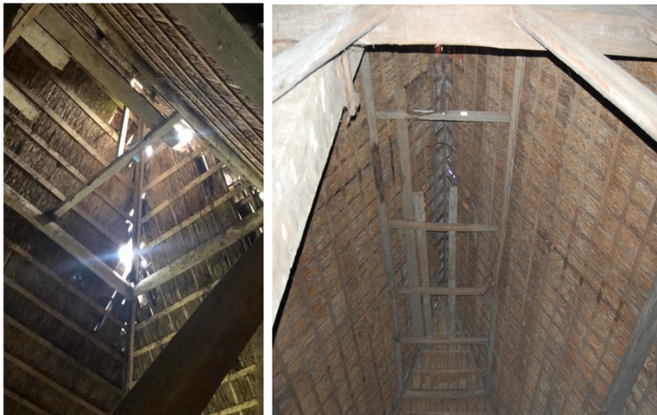
Foto 35 + 36 uitgezakt riet bij nok en hoekkepers.
