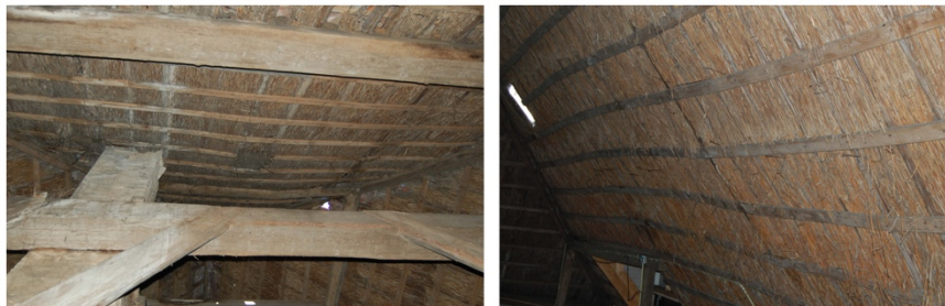
Foto 1+ 2 Doorbuiging (kruip) dakvlak en sporen.
