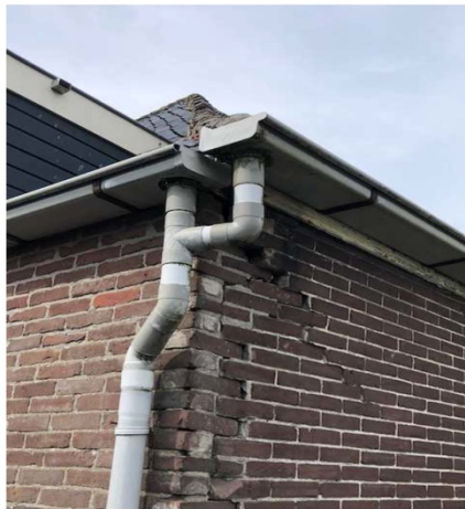
Foto 17 + 18 Zetting scheuren + wijken van gevel
