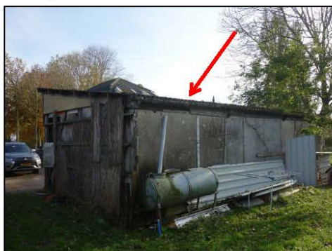
Foto 3 golfplaten aan binnenzijde zichtbaar
