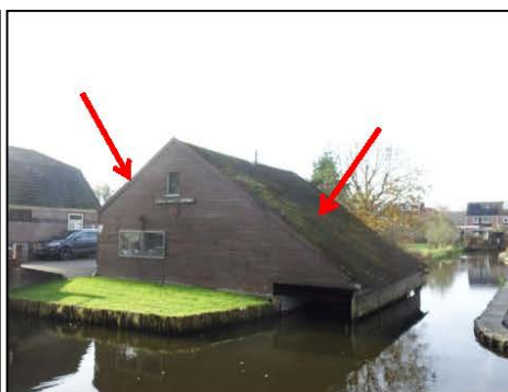
Foto 2 golfplaten aan binnenzijde zichtbaar
