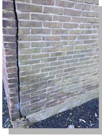
De muren zijn overal gescheurd
