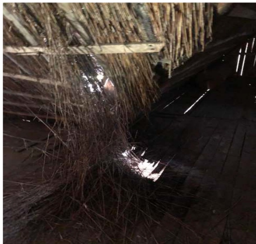
Foto 7 Kilpeperconstructie staart aangetast en verzakt.
