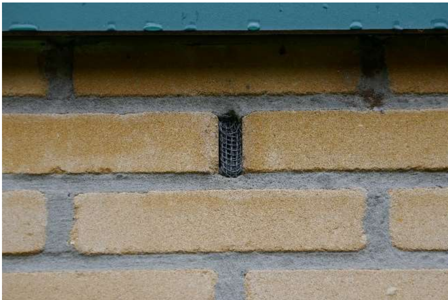
Foto 4: Open stootvoeg met een afdichting van ijzergaas
