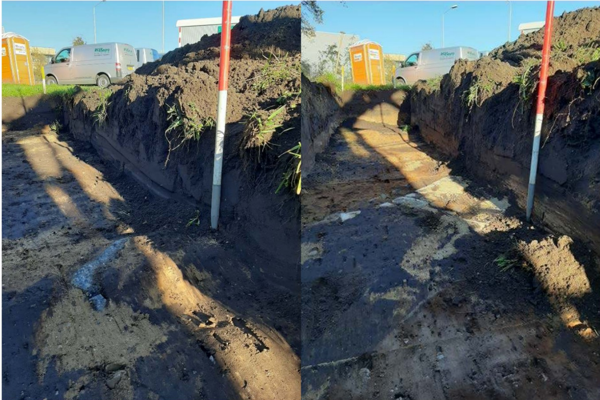
0,4 m-mv restanten puin
