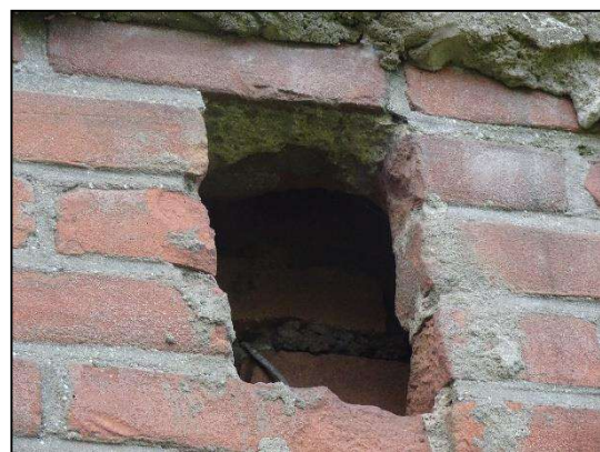
Figuur 12. Openingen in de muur die gebouwbebouwende vleermuizen toegang bieden tot de spouwmuur.
