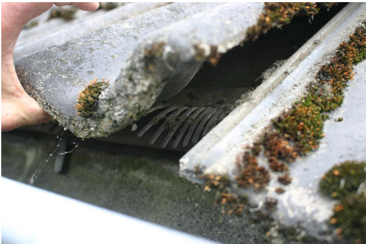
Figuur 4.2.2. Onder de onderste rij dakpannen is overal vogelschroot aanwezig.
