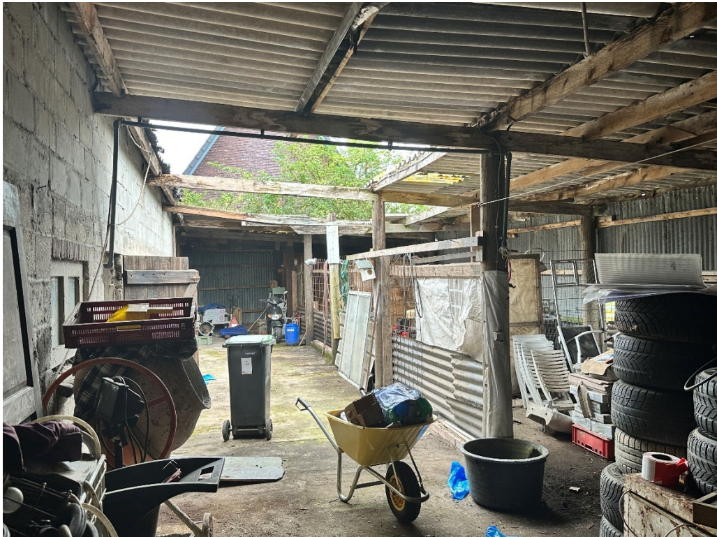
• Afbeelding 15: Binnenzijde achterste bijgebouw, dak beschadigd
