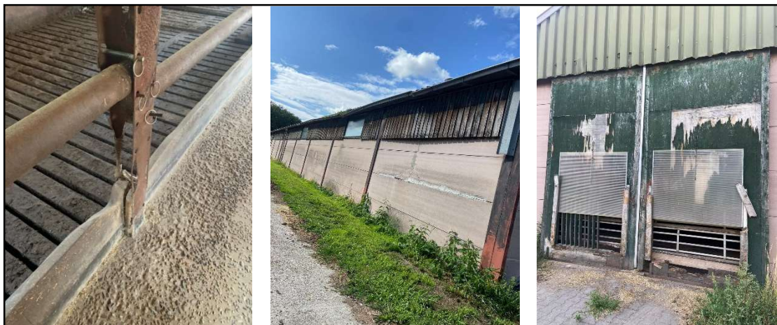
Figuur 2 Voorbeeld schuren Hottenvoortsweg 18 in slechte staat
